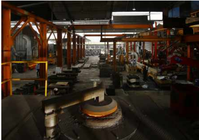
*Horno de inducción con capacidad de 3 TON- 1800 KW . Cuenta con una cubierta motorizada para evitar la propagación de gases.
